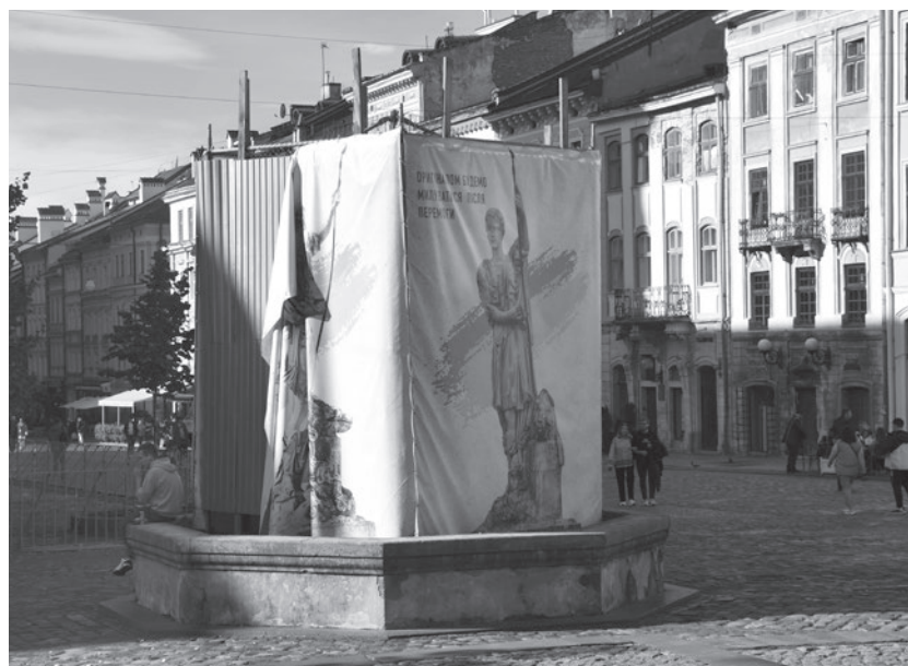
Statua Neptuna na Rynku we Lwowie, zabezpieczona za pomocą rusztowań i blachy falistej, styczeń 2023
